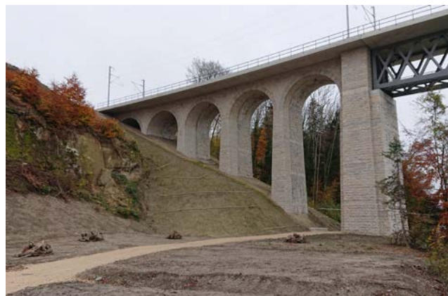
© Fürst Laffranchi Bauingenieure GmbH
