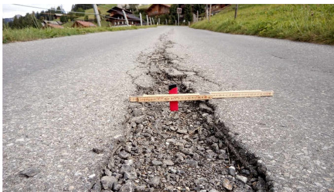
Documentation des dommages routiers (Roland Christen, InfraTrace).
