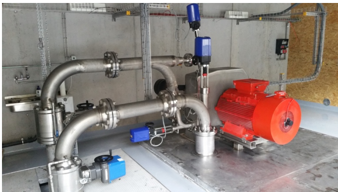
Centrale à eaux usées Meiersboden, Churwalden (Rabiosa Energie).
